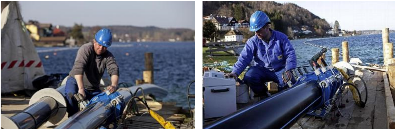
Abbildung 82: Endmontage und Lagerung der 2,6 km langen Trinkwasserleitung im Attersee im Jahr 2009 (URL: http://www.energieag.at/ [20.07.2015]).
