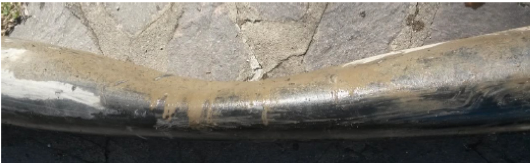
Abbildung 21: Deformation (> 50%) wegen Beschädigung durch Dritte (Bildquelle: WV Wörtersee Ost, 2015).
