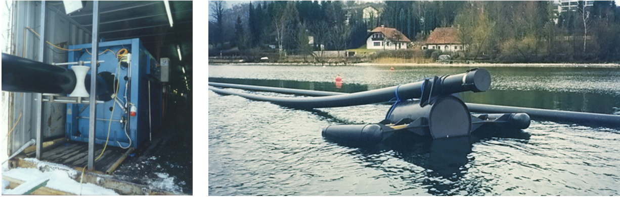
Abbildung 83: Produktion und Lagerung der 6,5 km langen Trinkwasserleitung im Traunsee im Jahr 1998 (Bildquelle: AGRU Kunststofftechnik GmbH).
