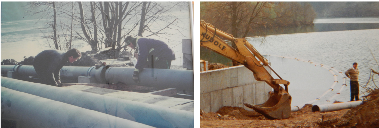
Abbildung 16: Herstellung der Seedruckleitung aus Gussrohren (Bildquelle: AWV Völkermarkt-Jaunfeld). Links: Montage der Einzelrohre mit nur kleinen Beschwerungsgewichten an der Unterseite, Rechts: Schwimmende Rohrstränge vor dem Absenkvorgang.
