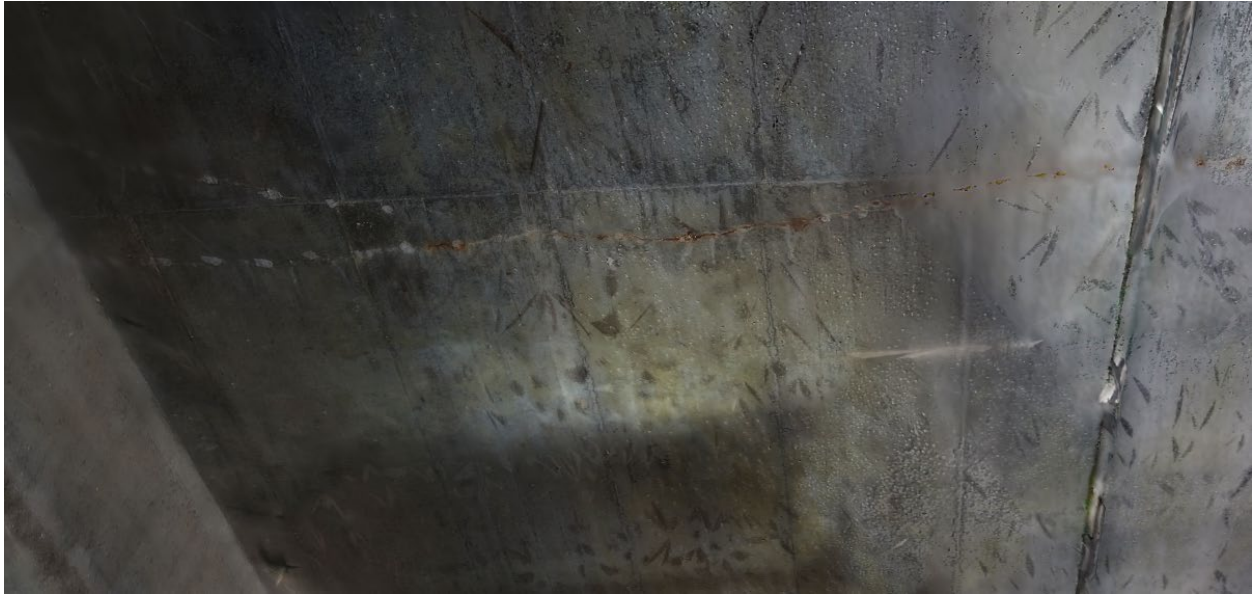
Abbildung 50: Modell SBW AWV Großsache-Nord / Riss mit Korrosion
