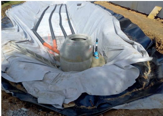
Abb. 7: Versickerungsbecken (TDC ZT-GmbH)
